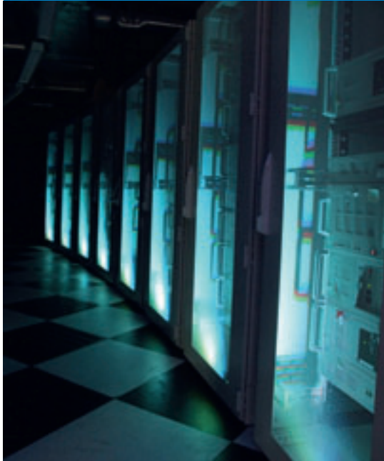
Ict-afdelingen proberen steeds meer apparatuur in een rack te plaatsen, meer dan de koeling vaak aan kan.
